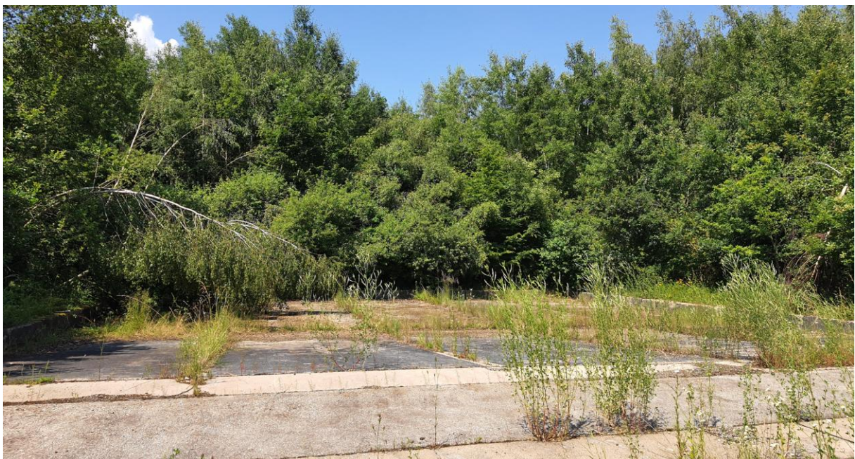
Abbildung 36: Betonbecken 4 mit wenig Vegetation, Jost 2024
