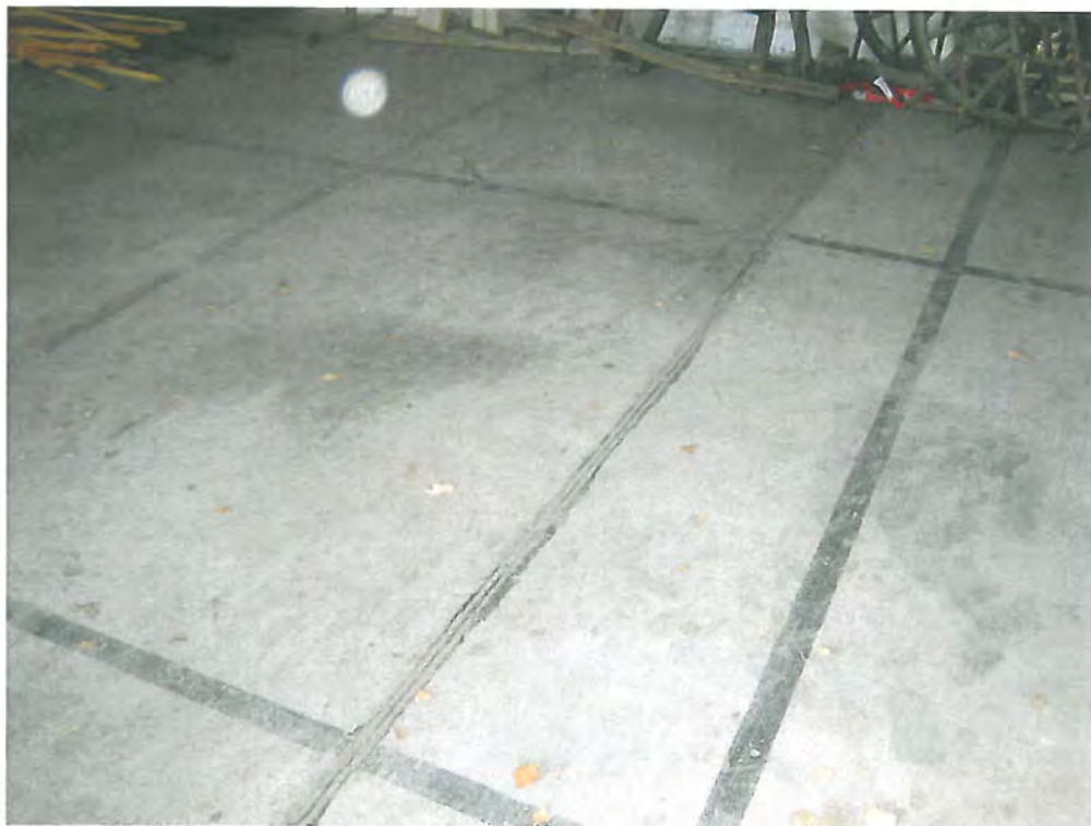
Bild 8: Hallenboden Halle 19 (KVF022)
