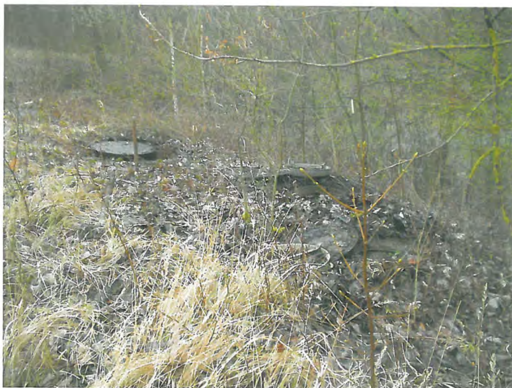
Bild 12: Abscheideranlage östliche Grundstücksgrenze (41)
