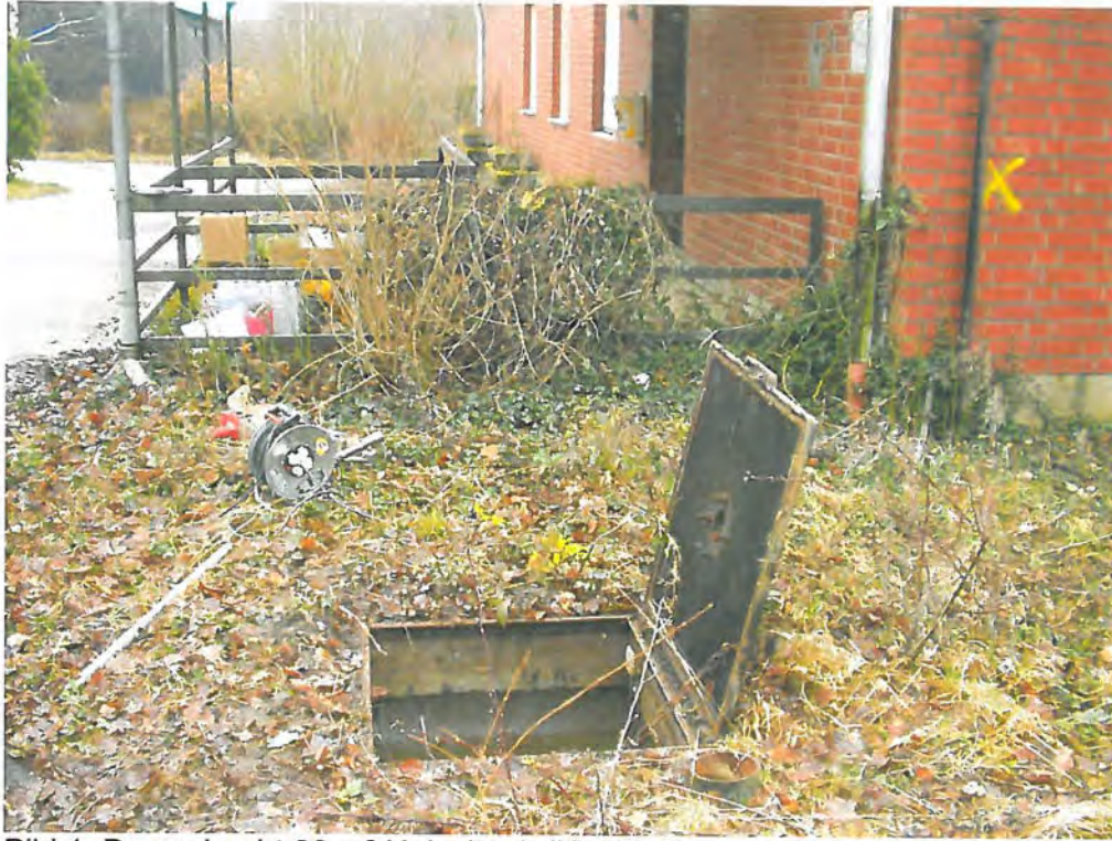
Bild 1: Domschacht 20 m³ Heizöltank (KVF024)
