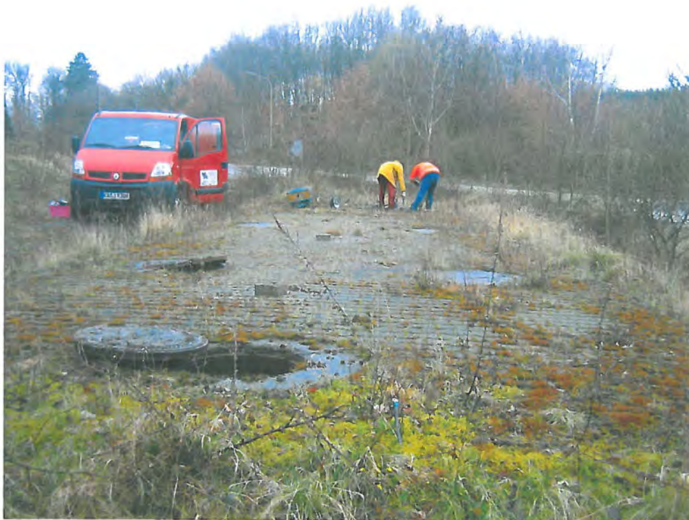
Bild 14: Zentrale Abscheideranlage (KVF018)
